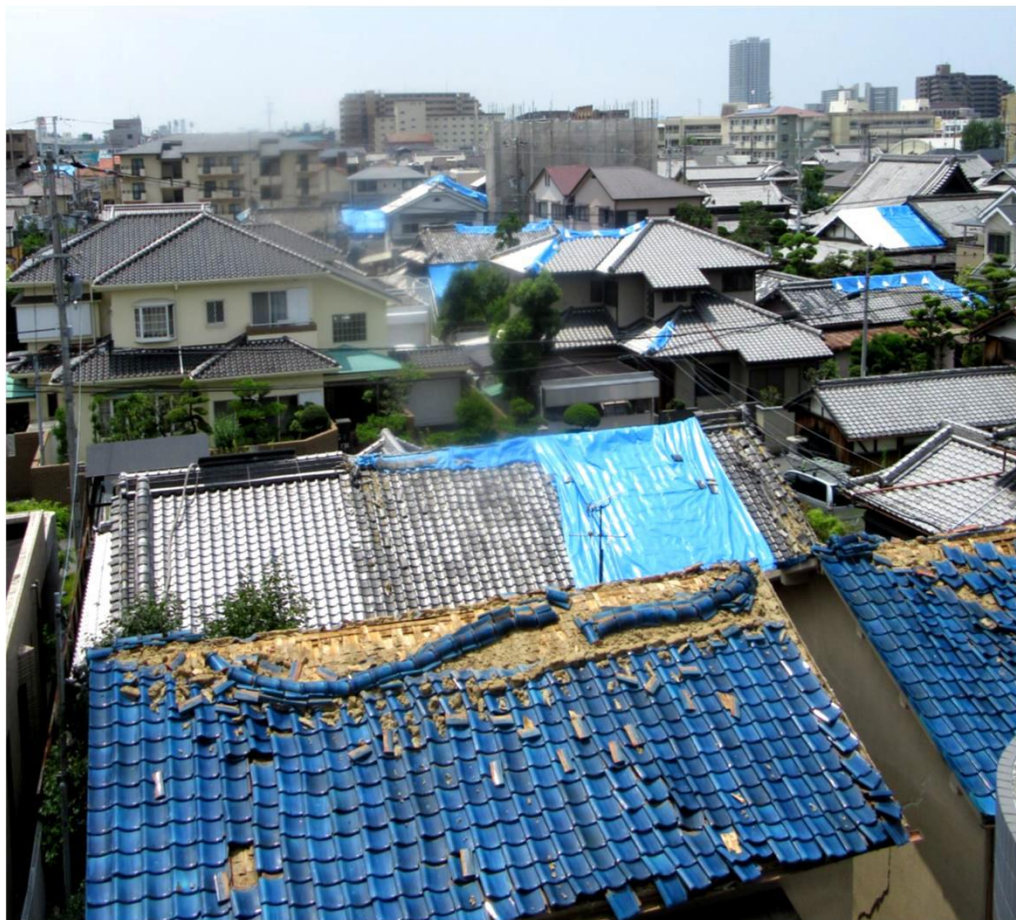
屋根瓦に被害があった住宅 （高槻市）
