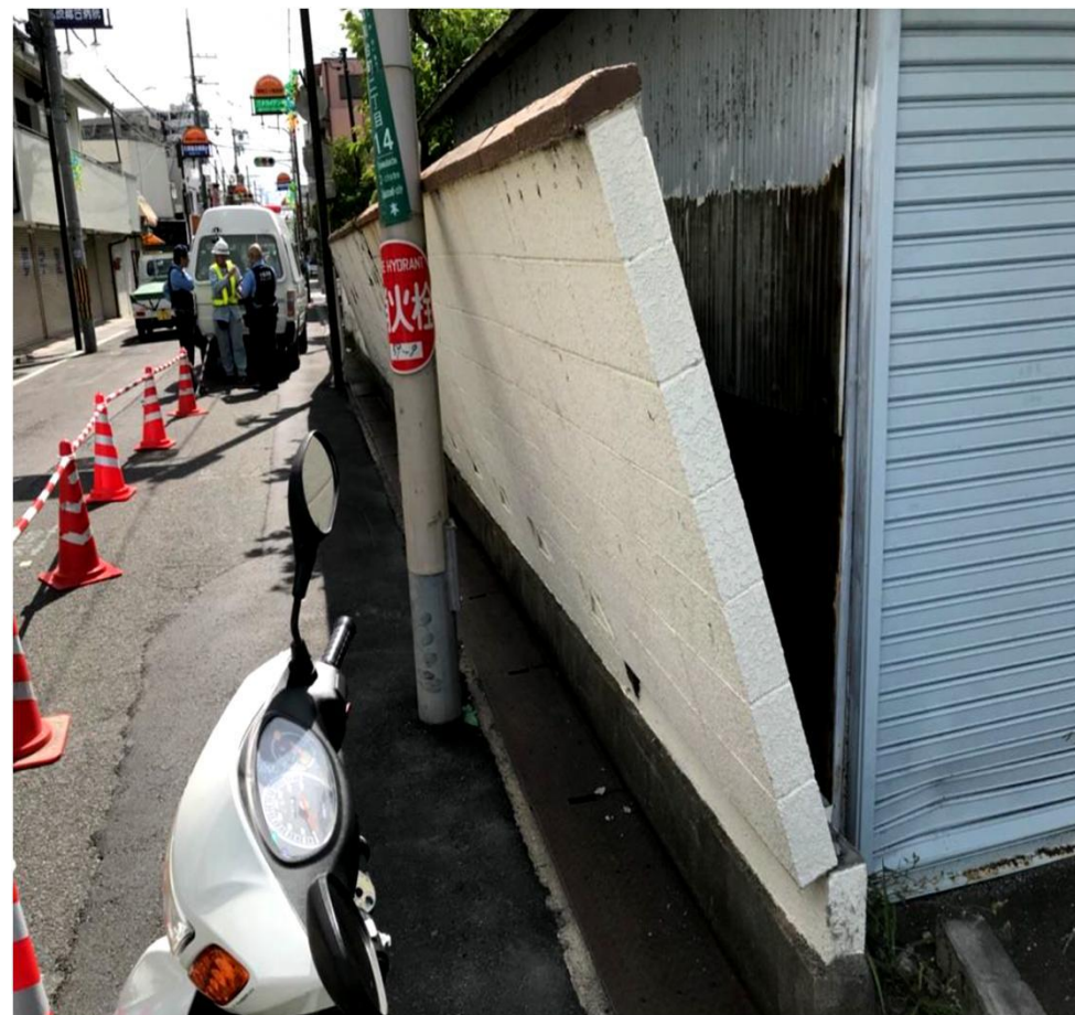
転倒したブロック塀 （高槻市）
